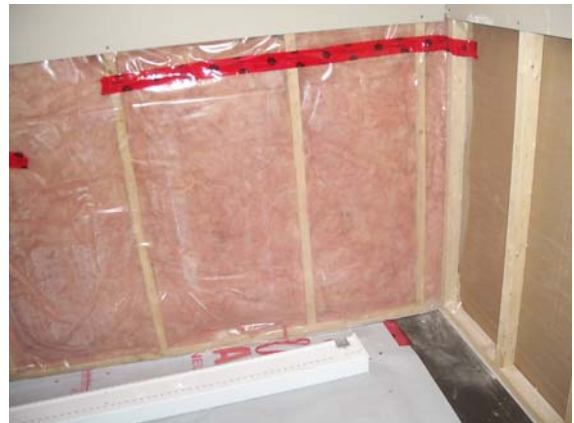
Photo 3 Mur porté alerte par les chiens, démontrant un aspect sain en surface.
