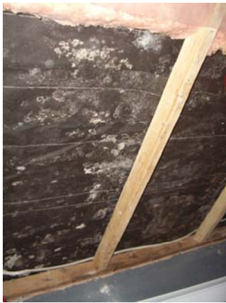
Photo 4 : Ouverture de surface du mur démontré à la photo 3, indiquant la présence visible des moisissures.
